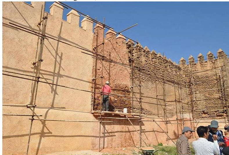
Figure 1 : Tranche d'une muraille Al Moahades (Bab Chaâfa) de la médina de Salé en phase de restauration.
